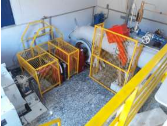
Grupo gerador com turbina Francis, 765[kW]
