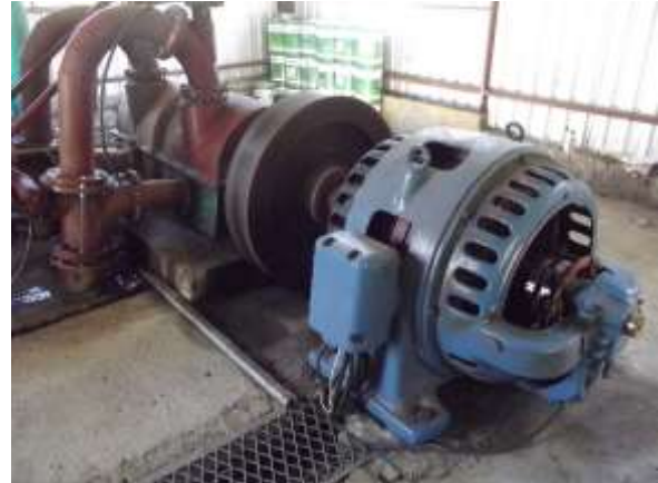
Grupo gerador com turbina Pelton, 136[kW]
