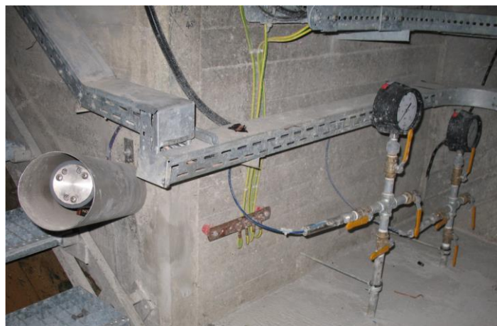
Figura-3- Piezômetros Automatizados em Galeria de Drenagem em Barragem de Concreto – Sensores de Corda Vibrante e Elétricos (Acervo pessoal do Autor).
